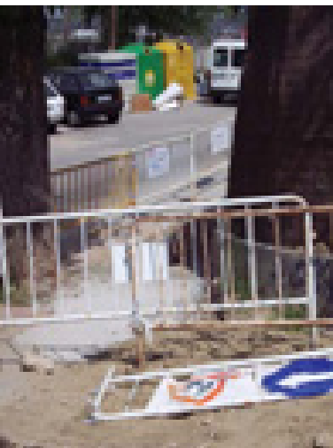
La rotura de la cañería se produjo a la altura de la urbanización Los Altos del Club de Campo
